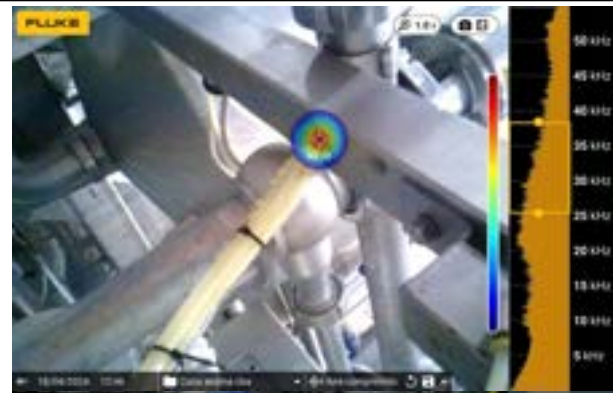
Imagen (40) con Pérdidas
