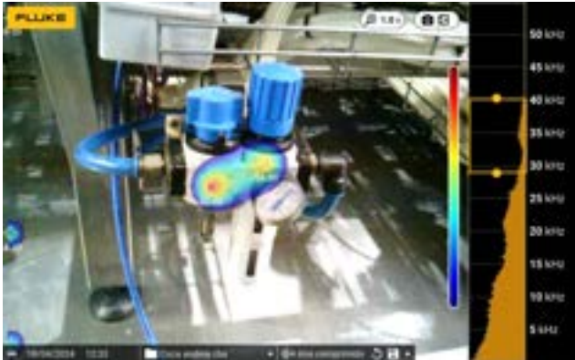
Imagen (30) con Pérdidas
