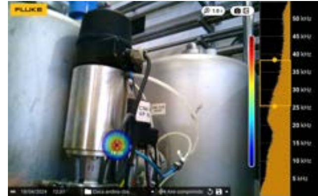
Imagen (33) con Pérdidas
